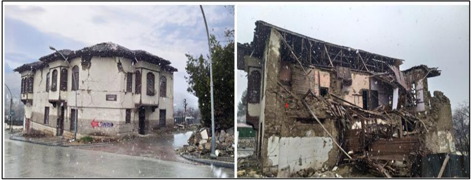
Fotoğraf 13. Ağır hasar alarak arka cephesi tamamen yıkılan Abdullah Ağa Konağı
