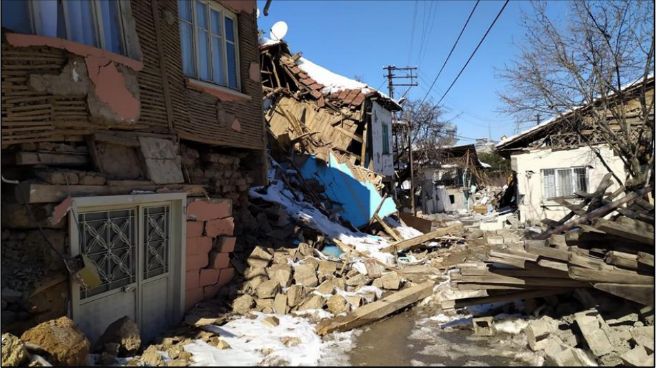
Fotoğraf 1. Hiroğlu mahallesindeki yapısal hasardan bir görüntü (14.02.2023)
