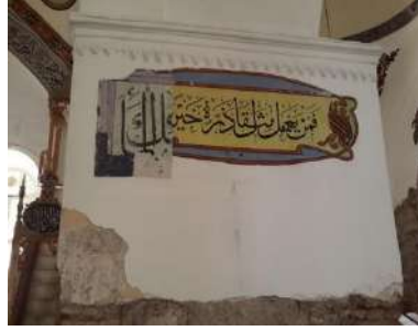
Foto 10. 2018 restorasyonu öncesi sıva raspaşı (üç kat kalem işi tabakasına rastlandı)
