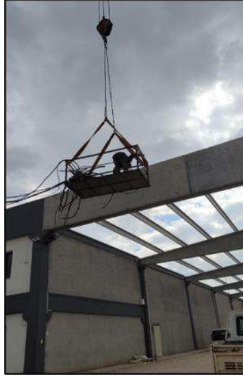
Şekil 3. Vinç ile personel taşınarak yapılan uygunsuz yüksekte çalışma uygulaması
