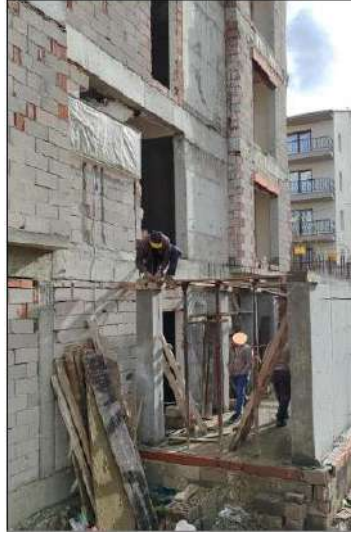
Şekil 4. Uygun olmayan iskele ve koruma önlemleri ile gerçekleştirilen yüksekte çalışma
