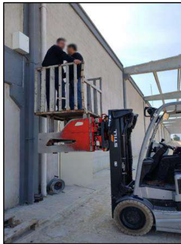
Şekil 2. Forklift ile uygun olmayan ekipman kullanılarak yapılan yüksekte çalışma
