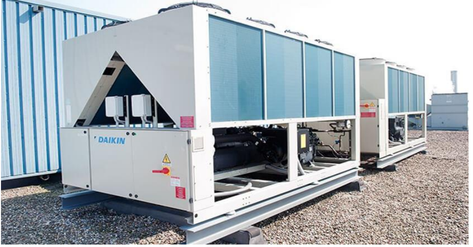
Şekil 2. Hava Soğutmalı Chiller Cihazının Dış Ünitesi [24]
