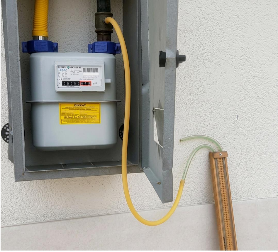
Şekil 13. U-Tipi Manometre ile Gaz Tesisatı Sızdırmazlık Testi.
