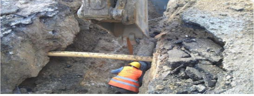
Şekil 7. Kazı çalışması sırasında kovanın tehlike oluşturan durumu (Erdoğan,2018).
