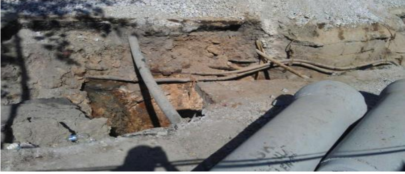
Şekil 8. Kazı çalışması sırasında mevcut altyapı hatlarına rastlanması (Erdoğan,2018).
