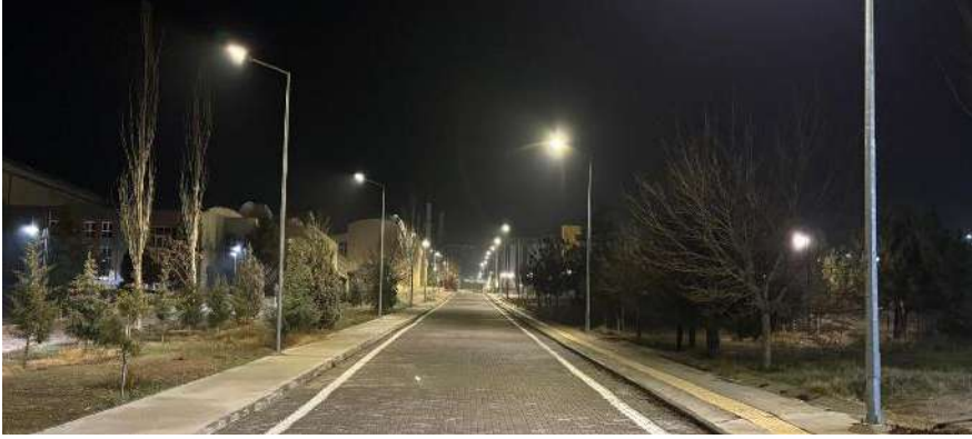
Resim 4: Kırıkkale Üniversitesi Yol Aydınlatması Örneği (Kaynak: Kişisel Arşiv)
