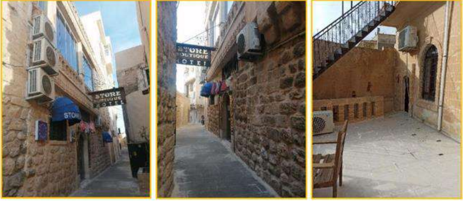
Şekil 5.15 Solda ve ortada, Stone Otel güney cephesi klima dış üniteleri; sağda 2. Kat terası güney cephesi klima motorları
