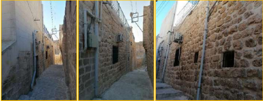
Şekil 5.16 Kasrı Abbas Pansiyon kuzey cephesi tesisat boruları ve klima dış ünitesi kullanımı
