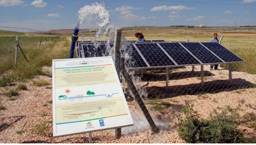
Şekil 12. Sulama Pompalarında Enerji Verimliliğinin Arttırılması Pilot Projesi (Anonim, 2021i)
